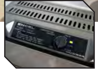
Steuerung mit Kontrollleuchte Controller with control light
